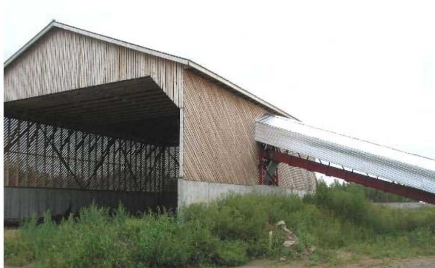
Figure 6 : Plate-forme de béton couverte
