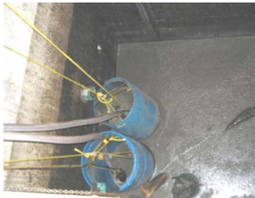
Figure 11 : Barils pour collecter le liquide de chaque section du bâtiment
